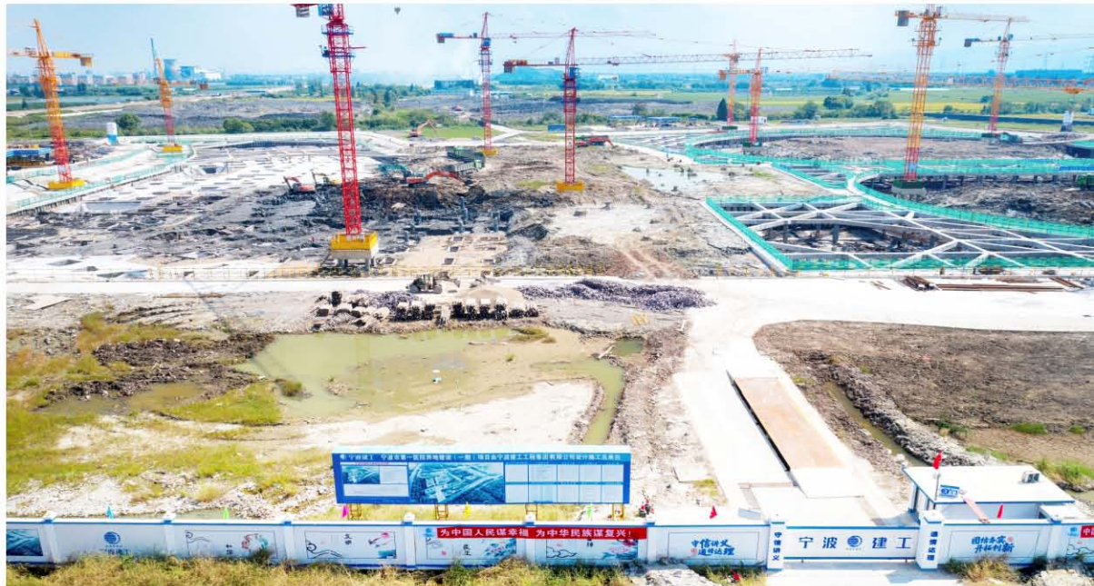
2018年12月15日，宁波市第一医院异地建设一期项目在方桥开工建设。该项目总投资15.2亿元，远期总床位规模为2200张，总用地面积约420亩。图为施工现场。
